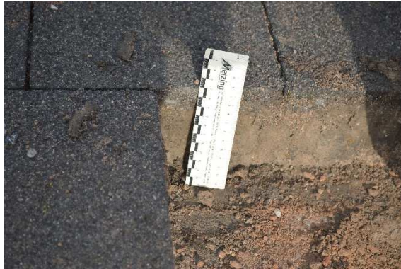
Foto 2: Zermahlenes bzw. verschlammtes Fugenmaterial Probestelle 1
