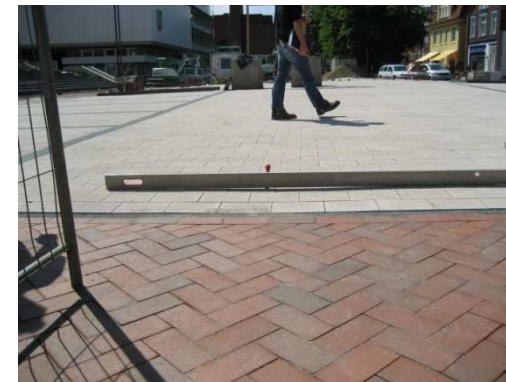
Foto IMG 3674: Unebenheit einer Pflasterdecke
