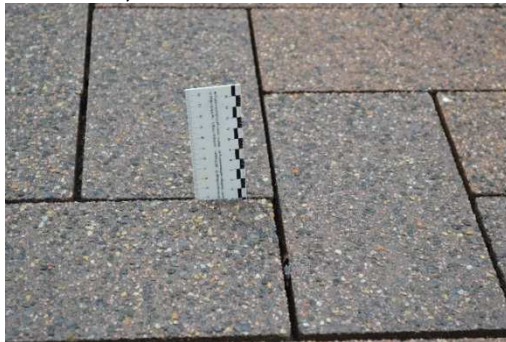
Foto 4: Fahrbahn 2 Monate nach Inbetriebnahme, Fugentleerung 4 cm
